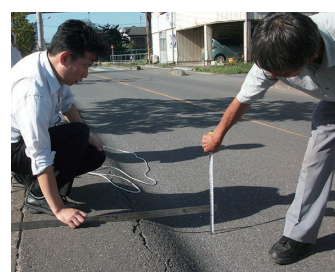
道路陥没を調査
